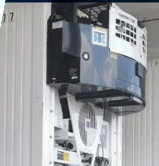
GEN SET: PÅHÆNGSGENERATOR
